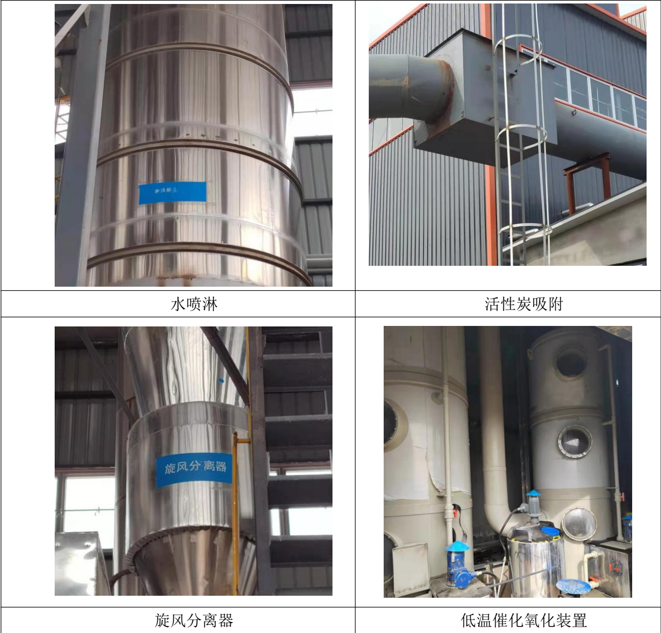
图 4-3 废气处理设施及排气筒标识图
